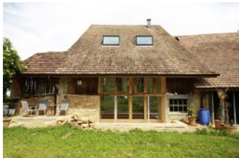
Auf der Gartenseite des Hauses wurden Flügeltüren aus Glas eingebaut – der Zugang zur gedeckten Terrasse und zum Garten. Zwei Dachgauben bringen noch mehr Licht in den Raum. ^
