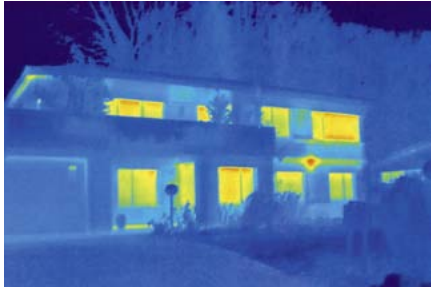
Normales Temperaturbild an der Wand, Schadstelle im rechten Bereich zwischen den Stockwerken. Leicht erhöhte Oberflächentemperatur im Fensterbereich. ^
